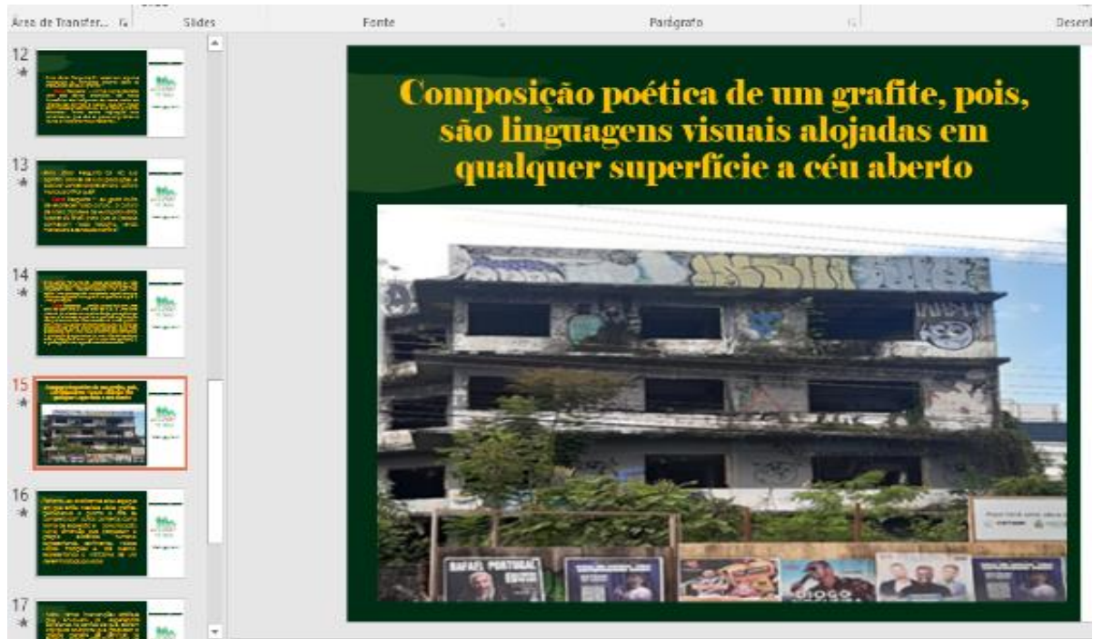
Figura 15: Av. Torquato Tapajós (Av. Constantino Nery), prédio em estado de abandono.
