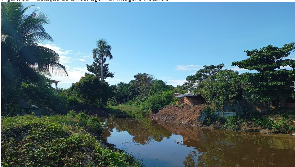
Figura 31 – Estação de amostragem B, margens instáveis
