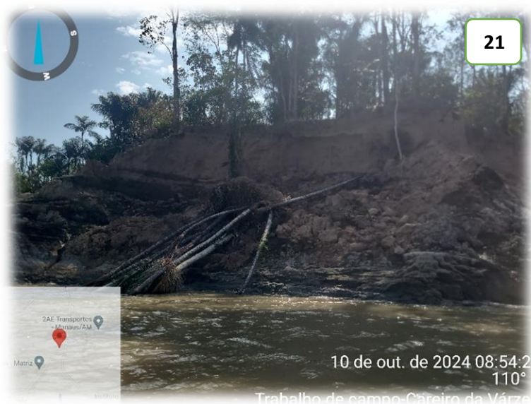
Figura 21: impactos ambientais (deslizamento de terra)
