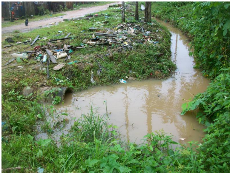
Figura 17: Entupimento da tubulação e acúmulo de lixo Fonte: Arquivo pessoal do líder do bairro, 2007
