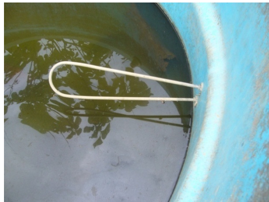
Figura 11. Aquecedor elétrico na caixa de abastecimento de água (3.000 W).
