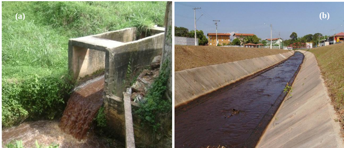
Figura 1: (a) Vista do lançamento; (b) Igarapé do Bombeamento, completamente poluído, no bairro Compensa, próximo ao condomínio Sargento Pantoja.
