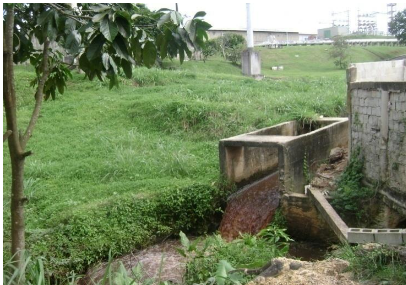
Figura 12: Lançamento de efluentes dos decantadores, flotadores e filtros.
