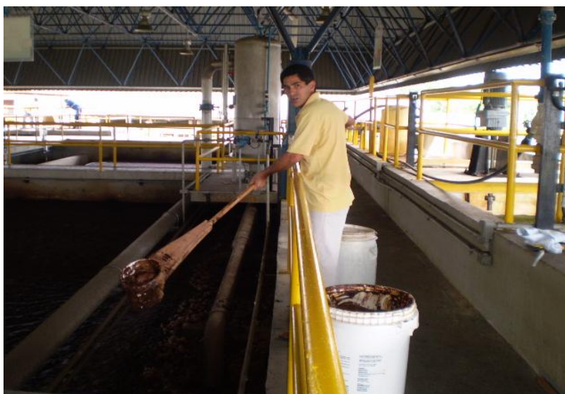
Figura 13: Tanque de floculação da ETA II.
