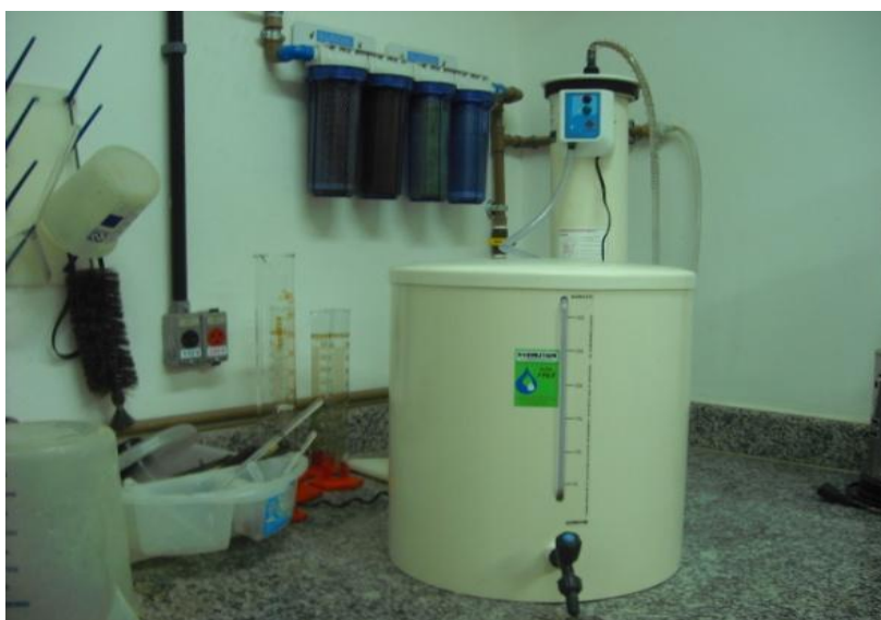
Figura 6: Depósito de água deionizada.
