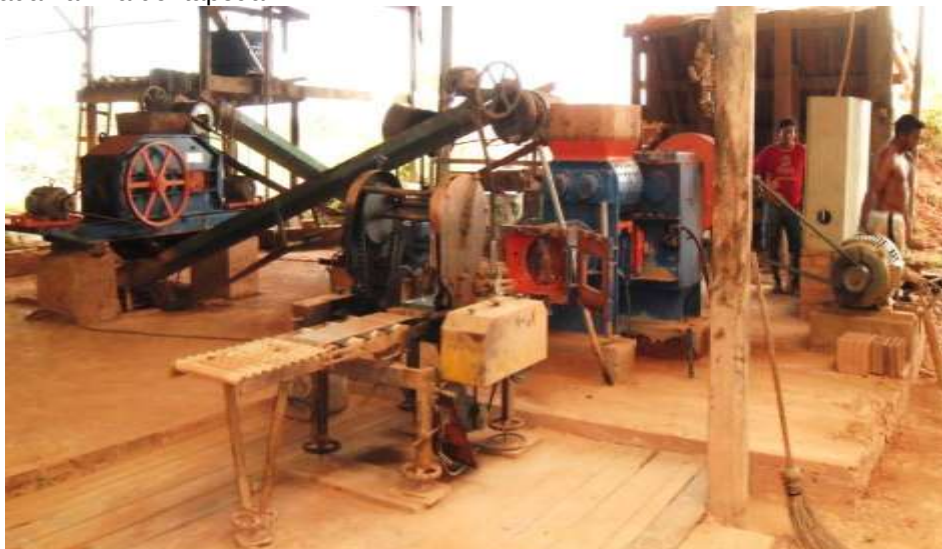
Figura 18 – Galpão de máquinas elétricas utilizadas na produção de tijolos - Olaria localizada na Vila do Itapéua.
