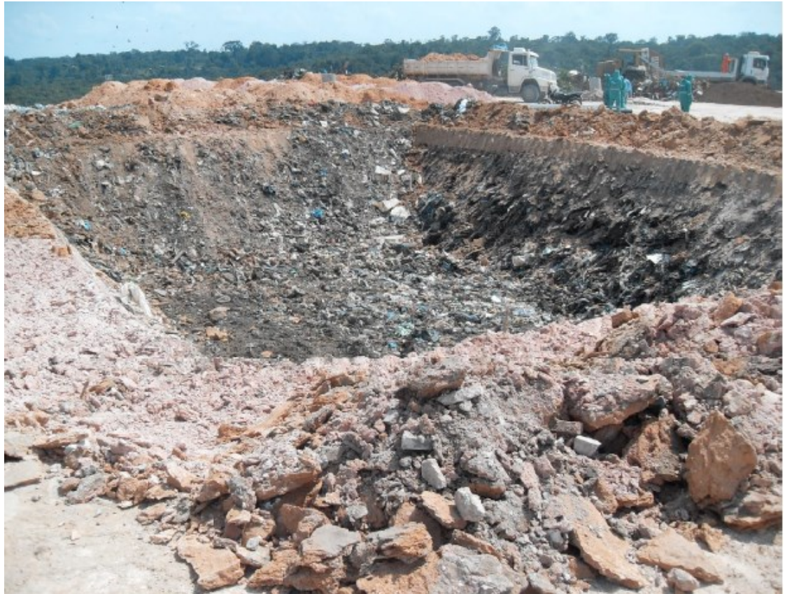
Fig. 5: Vala aberta para deposição de RSSS sem a correta impermeabilização
