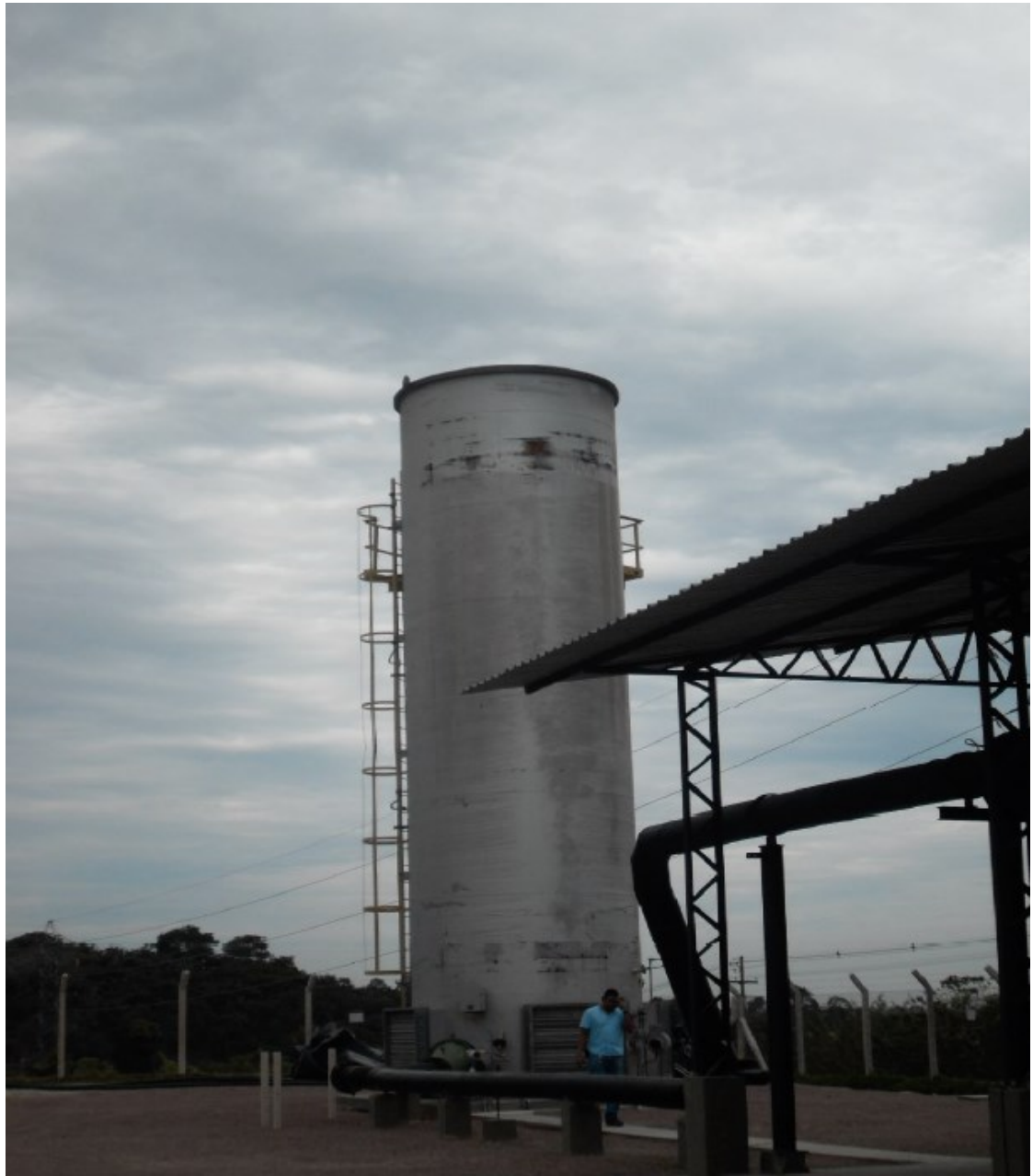
Fig. 10: Flare: cilindro fechado de grandes proporções onde é realizado a queima do biogás Fonte: Relatório de Auditoria Operacional realizada no Programa de Governo “Manaus mais Limpa”, na área de Resíduos Sólidos Urbanos – RSU 2010
