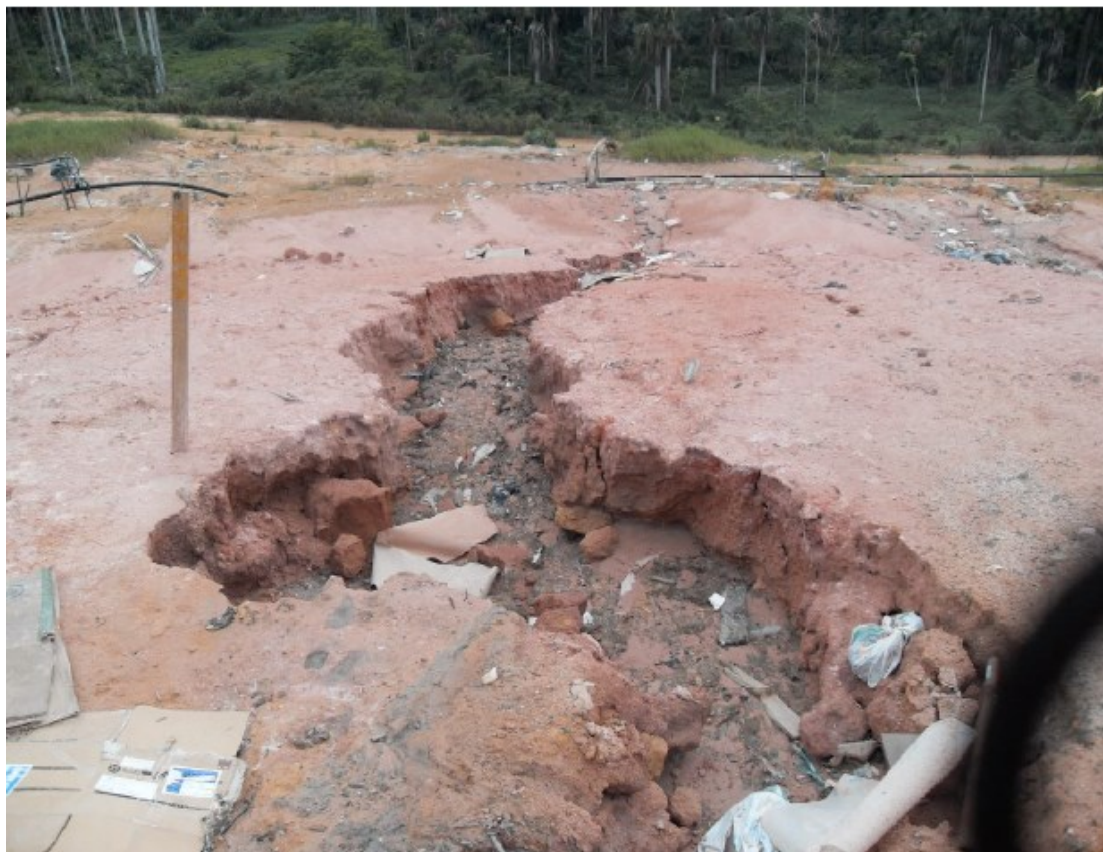
Fig. 1: Erosão das células de deposição.
