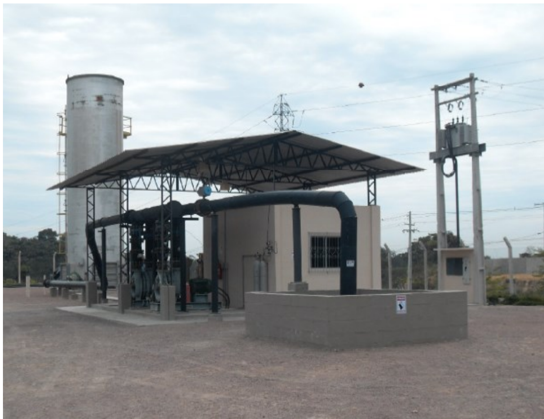
Fig. 9: Usina de gás.
