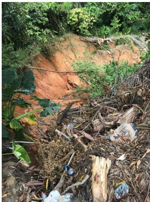
Figura 21 - Desgaste erosivo na borda esquerda da voçoroca 4
