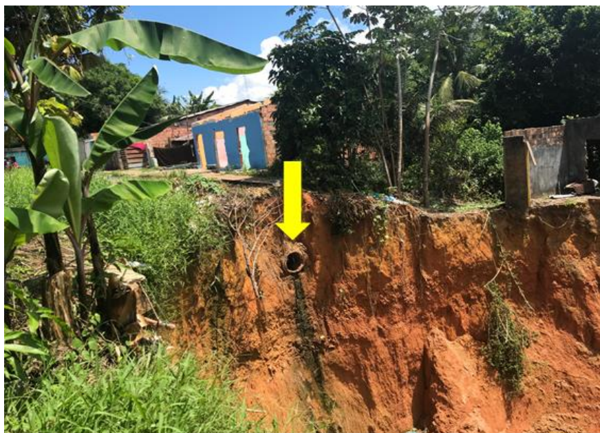
Figura 25 - Voçoroca 5, com destaque (seta) para a drenagem pluvial na cabeceira da incisão
