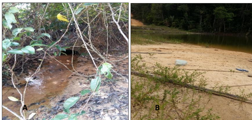
Figura 22 - Problemas de drenagem no ramal da Água Preta/Areal
