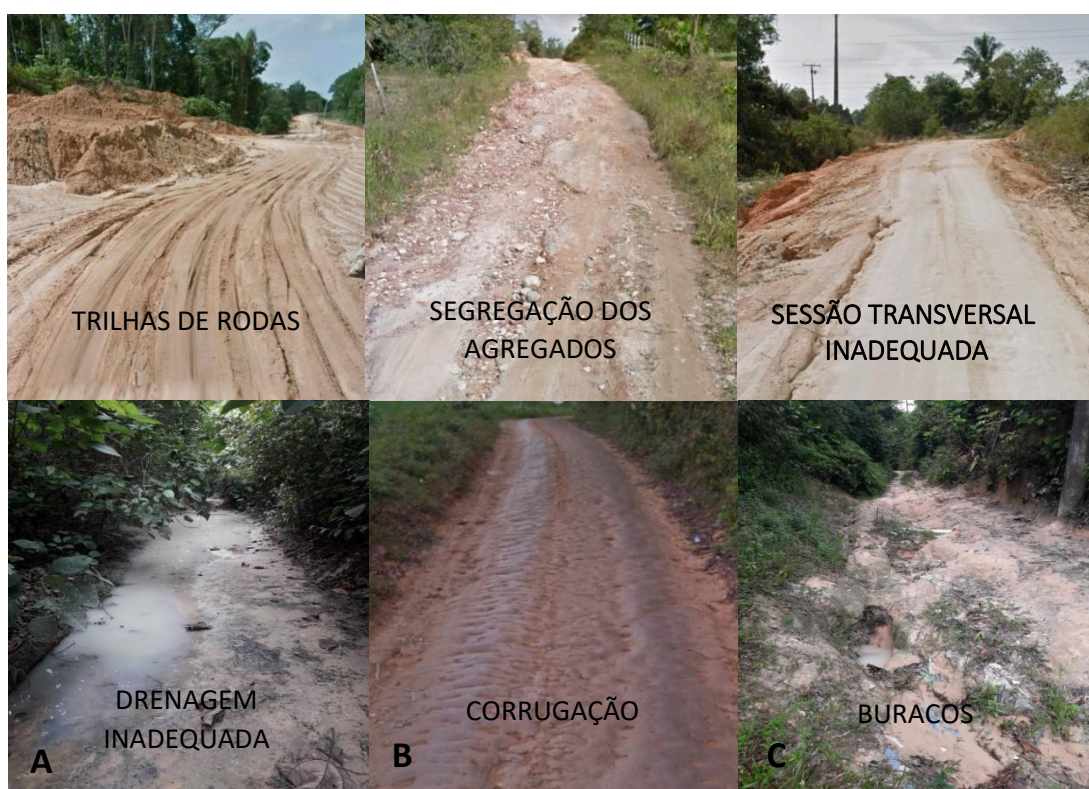
Figura 31 - Tipos de defeitos no corpo estradal do ramal Água Preta-Areal
