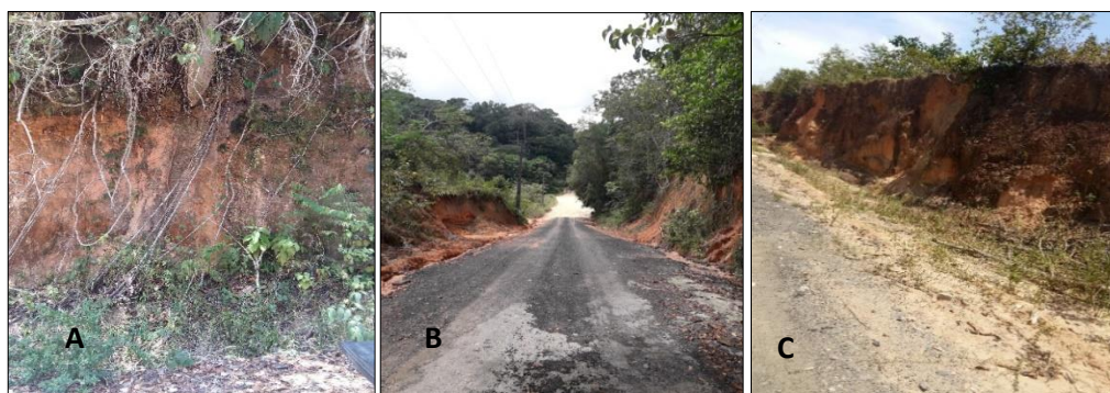
Figura 20 - Processo erosivos em talude de corte
