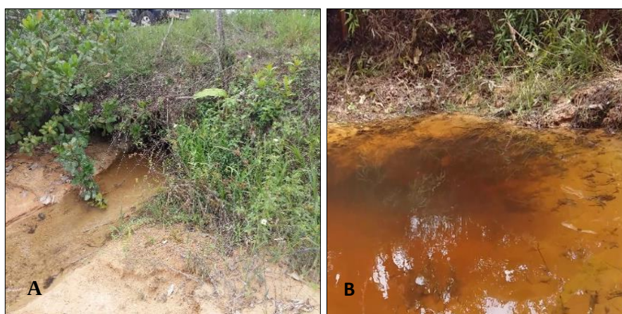
A: Bueiro praticamente soterrado; B: Bueiro abaixo do nível da água, ocasionado pelo peso dos caminhões carregados de areia. Fonte: levantamento de campo, 2018. Fotos: Maria de Fátima da Silva.
