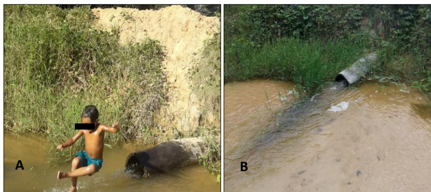
A: Bueiro de pau ocado, colocado no início da construção. Foto: cedida pelo morador (pai da criança); B: Assoreamento do leito (jusante), menor fluxo de água. Fonte: Levantamento de campo, 2018.
