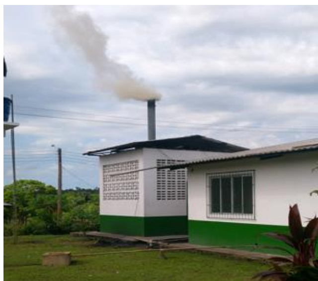
Figura 44 – Parte externa da caldeira da ASSOAB
