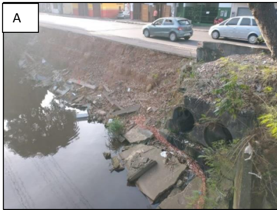
Figura 14 - Pontos de erosão
